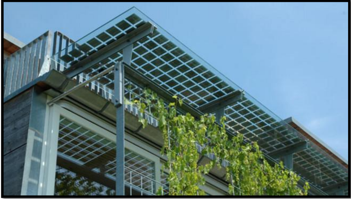
Şekil 5.3: Konutlarda saçak üzerine yerleştirilmiş fotovoltaik paneller [Url-22].
