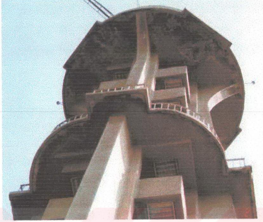
Resim 3.3 Paraşüt Kulesinin balkonlarının döşemelerinde oluşan bozulma.
