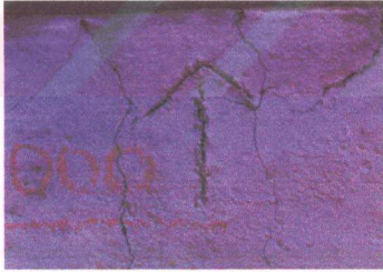
1000 °C ve üstündeki sıcaklıklarda derin çatlaklar ve gri-beyaz rengin oluşması
