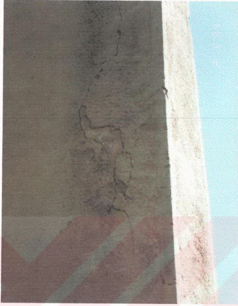
Resim 3.7 Betonarme birleşimli taşıyıcı eleman yüzeyinde oluşan çatlaklar ve kabarmalar.
