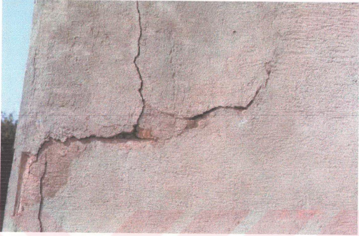
Resim 3.6 Yapının taşıyıcı elemanının dış yüzeyinde taraklı mozaiklerde oluşan çatlakların yakından görünüşü.
