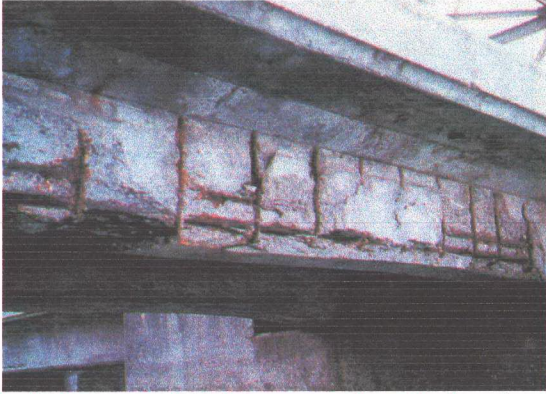
Resim 1.7 Deniz suyu etkisi ile betonarme elemanda oluşan bozulma.
