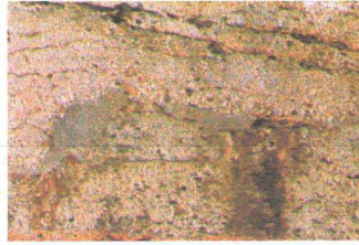
Resim 1.8 Alkali-Silika tepkimesi sonucunda betonda oluşan çatlaklar, kabarmalar, ufalanmalar ve dökülmeler.
