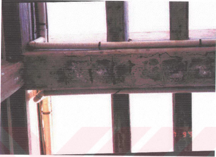
Resim 3.10 Açıkta bulunan kirişlerin alt alın yüzlerinde oluşan bozulmanın yakından görünüşü
