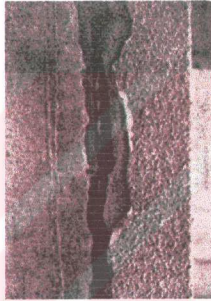
Resim 1.5 Çok sık aralıklarla boyuna donatı konulmuş kolonda aderans yokluğu çatlağı- Akkum Apartmanı, İzmir, 1974. (Bayülke, 1977, s.42).
