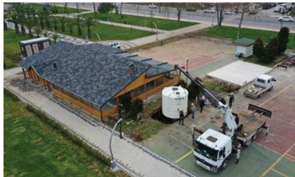
Şekil 2.45. Ordu Doğa Kafe Çatı Yağmur Suyu Hasadı (YHD, 2022)
