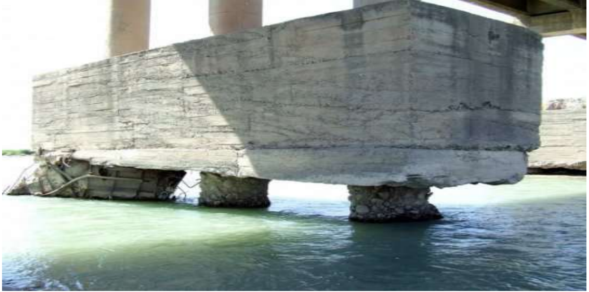
Şekil 4.4. Adıyaman Göksu köprüsü ayaklarında oluşan oyulma, (URL 7, 2020).
