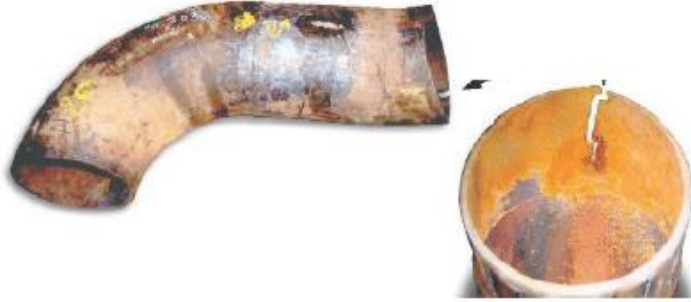
Şekil 2.49. Boru ek yerinde erozyon korozyonu [127]
