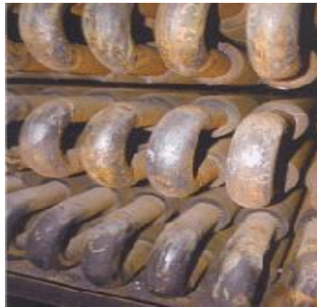
Şekil 2.48. Isı değiştiricilerde yüksek sıcaklık korozyonu [127]
