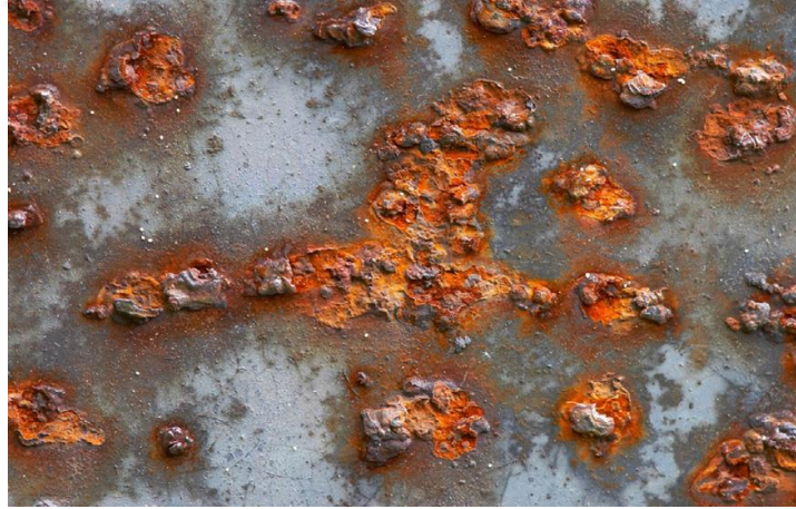
Şekil 2.45. Taneler arası korozyon hasarı [108]
