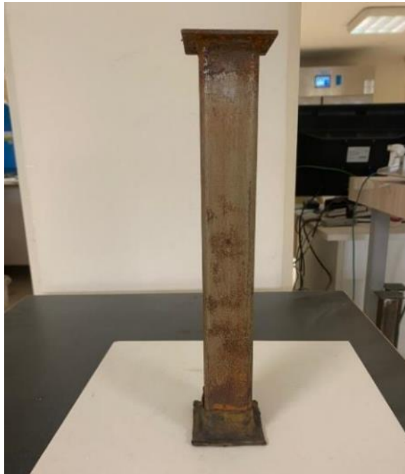
Şekil 3.4. Korozyon hasarına uğrayan profil örneği
