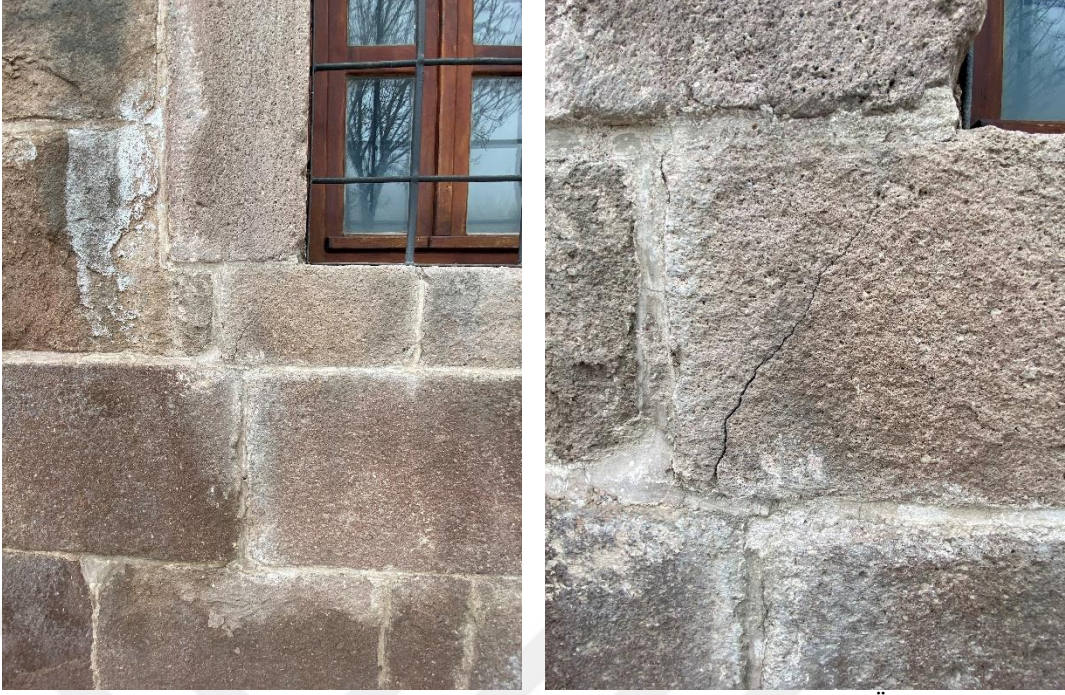
Fotoğraf 2.1. Şifâhâne Mescidinde görülen çatlak oluşumu (Ünal, 2023)
