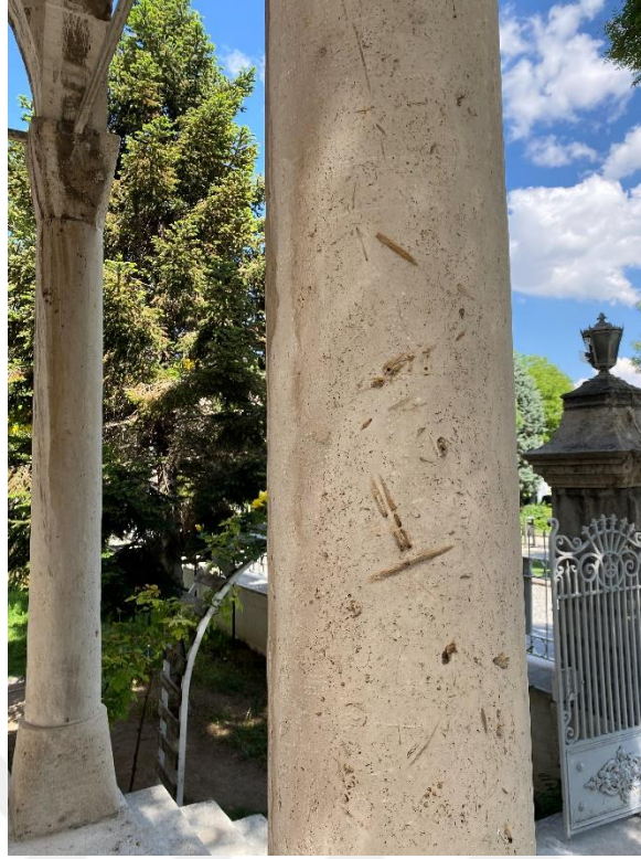
Fotoğraf 2.13. Konya Sanayi Mektebi giriş revağındaki sütun gövdelerinde tespit edilen mekanik hasarlar (Ünal, 2023)
