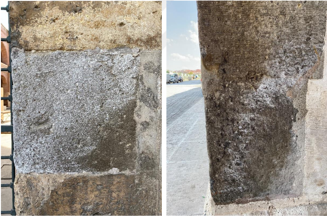
Fotoğraf 2.18. Konya Sırçalı Medrese yapı malzemelerinde görülen tuzlanma (Ünal, 2023)
