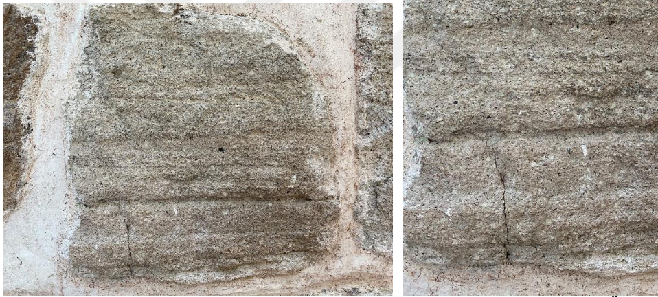
Fotoğraf 2.2. Hoca Ahmet Fakîh Camisinde yapı malzemesi olan taşta görülen çatlak (Ünal, 2023)
