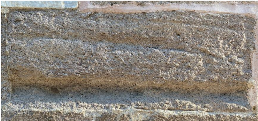
Şekil 2.12. Hoca Ahmet Fakih Camisindeki taşlarda görülen diferansiyel erozyon (Ünal, 2023)
