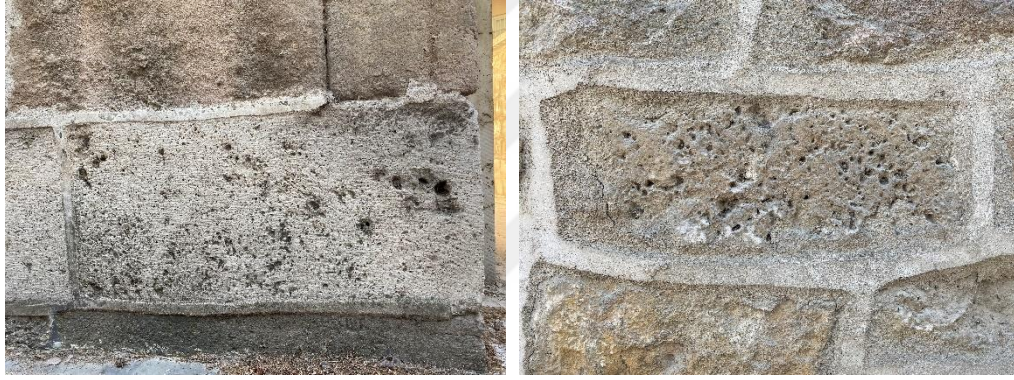
Fotoğraf 2.10. Şeyh Osman Rûmî Türbesindeki yapı malzemelerinde tespit edilen alveolar ayrışma (Ünal, 2023)
