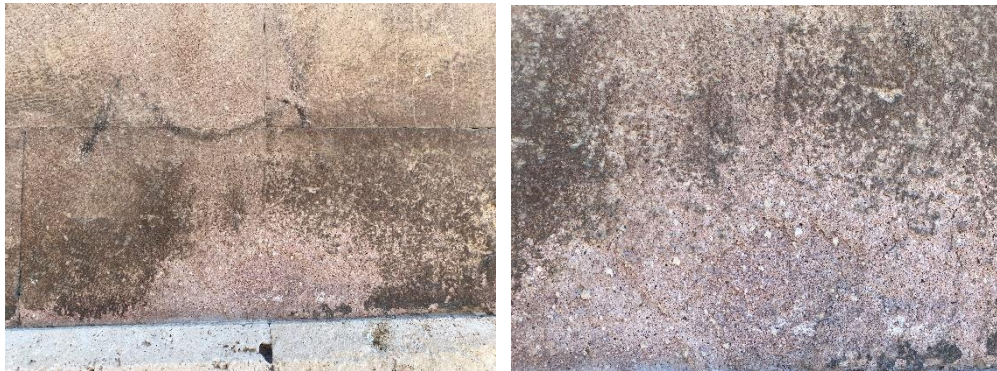
Fotoğraf 2.7. Konya Lisesi'nde yapı malzemesinde görülen pullanma (Ünal, 2023)
