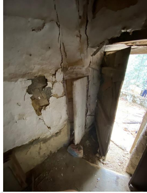
Görsel 3.32 Odalar Arası Geçiş İçin Yapılan Küçük Kapı
