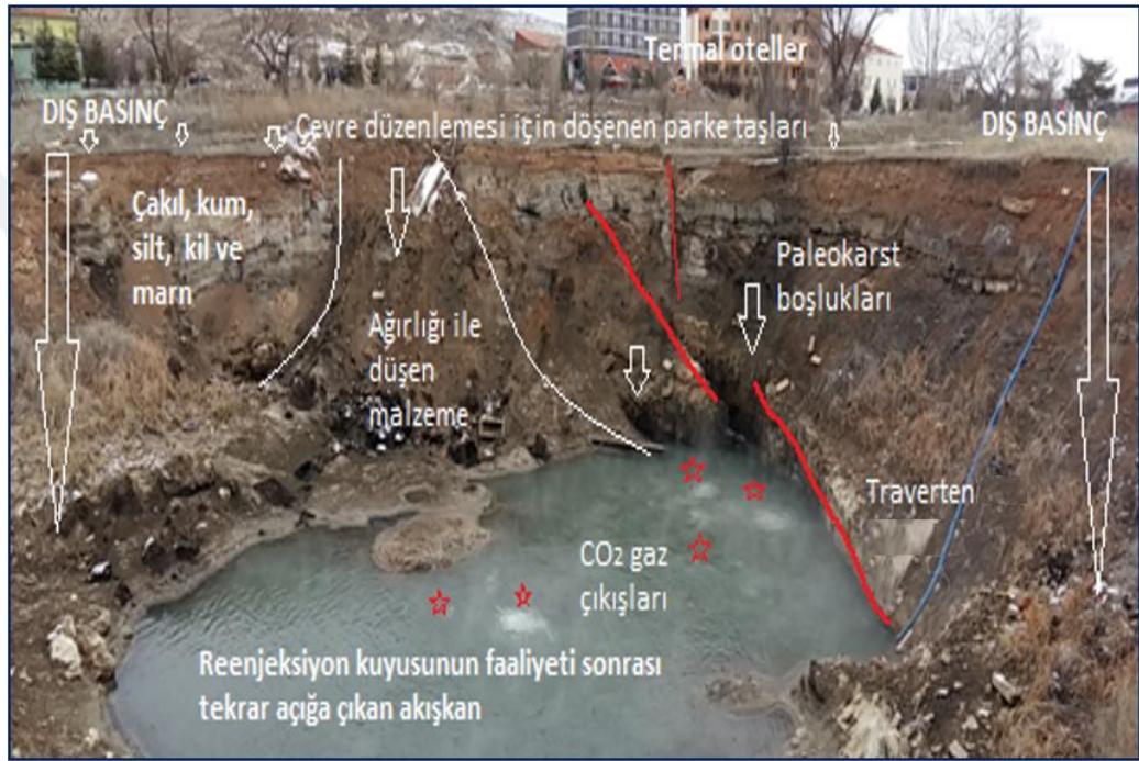
Şekil 3.21: Çöküntüde reenejeksiyon kuyusu ve toplama havuzu sonrasında tekrar gözlenen su çıkışları.
