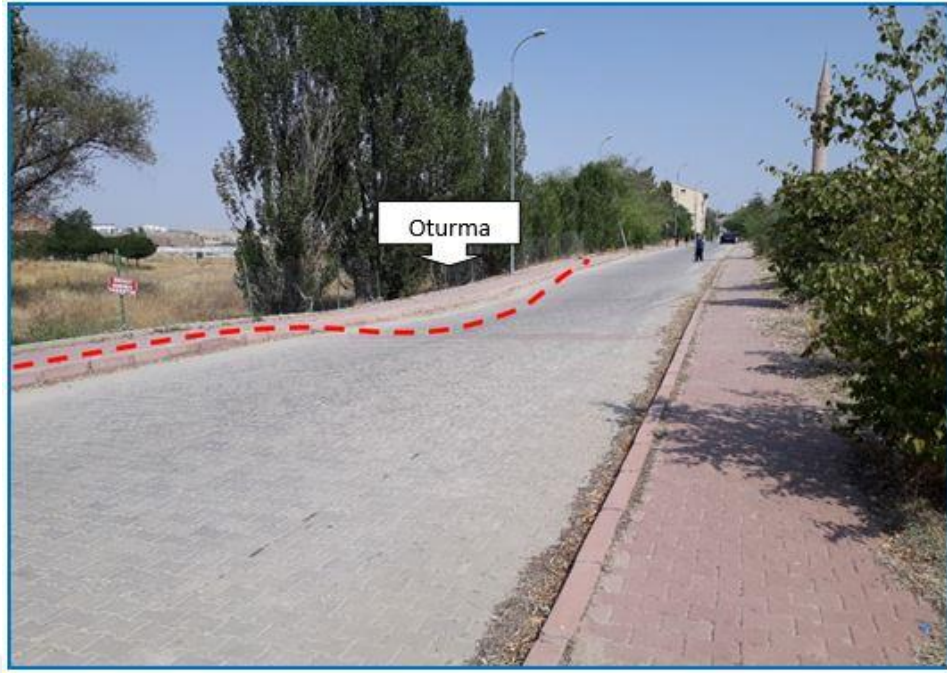
Şekil 3.16: KJA’da çöküntünün doğusunda taşıt yolu üzerindeki deformasyon.
