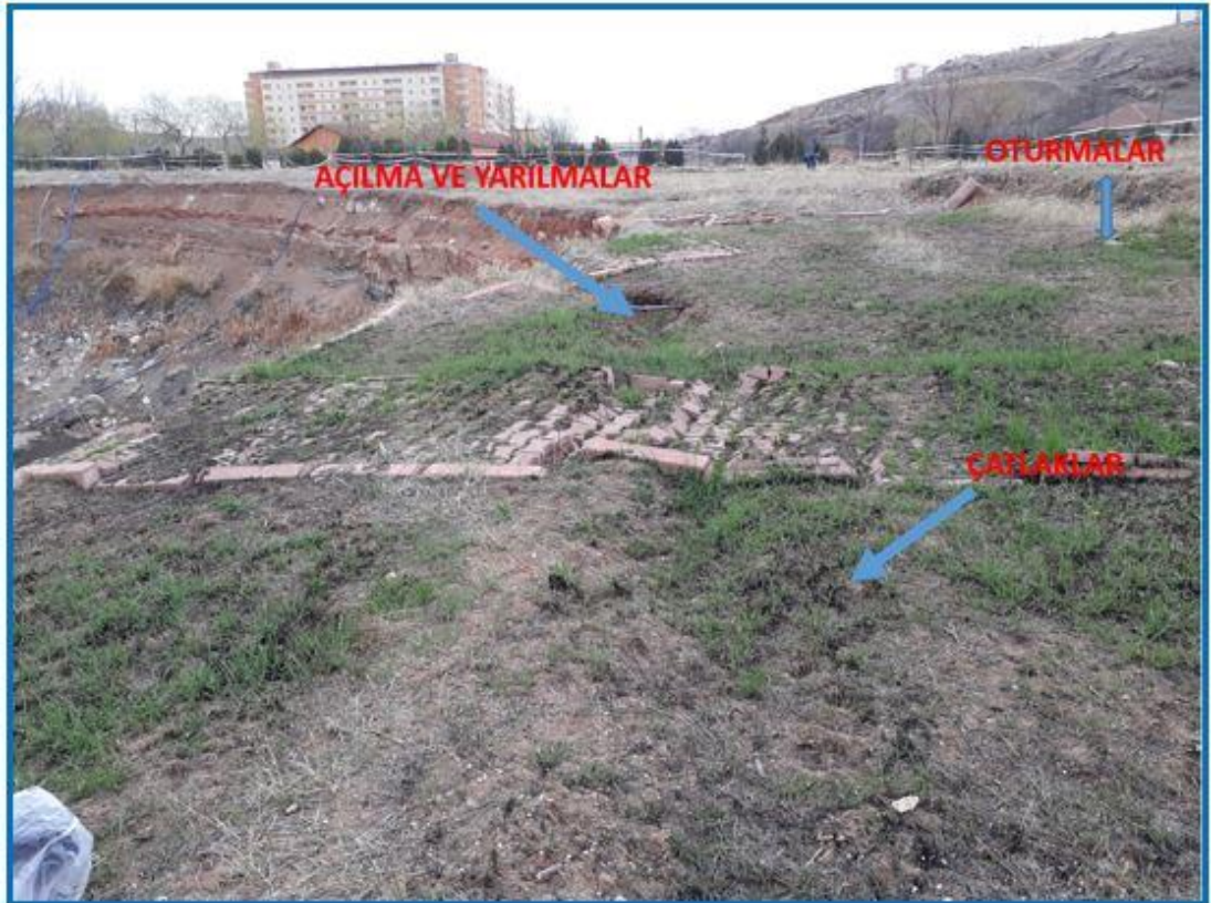
Şekil 3.15: KJA'da çöküntü çevresindeki çatlak, açılma ve oturmalar.
