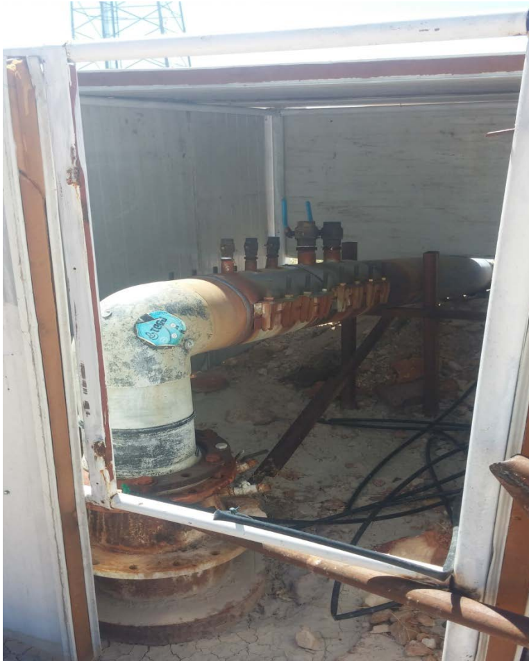
Şekil 4.4: Kozaklı merkezi ısıtsa sistemi reenjeksiyon kuyusu
