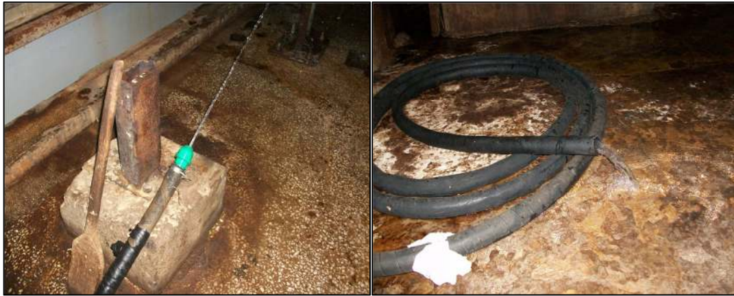
Şekil 5.7 Su hortumlarının daratılması ve vana kaçaklarının önlenmesi.
