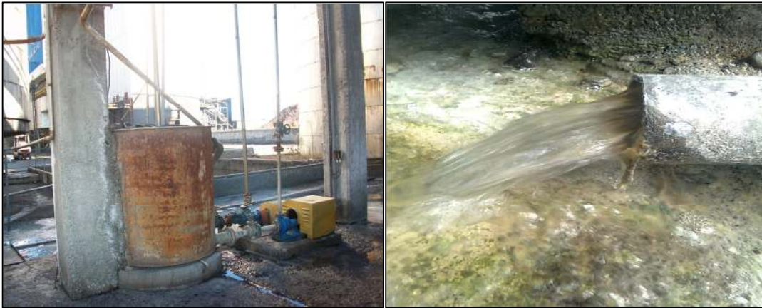
Şekil 5.9 Soğutma sularının toplanması ve geri kazanılması.
