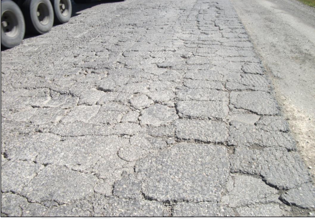
Şekil 1.2. Üstyapı tabakası çatlak oluşumu
