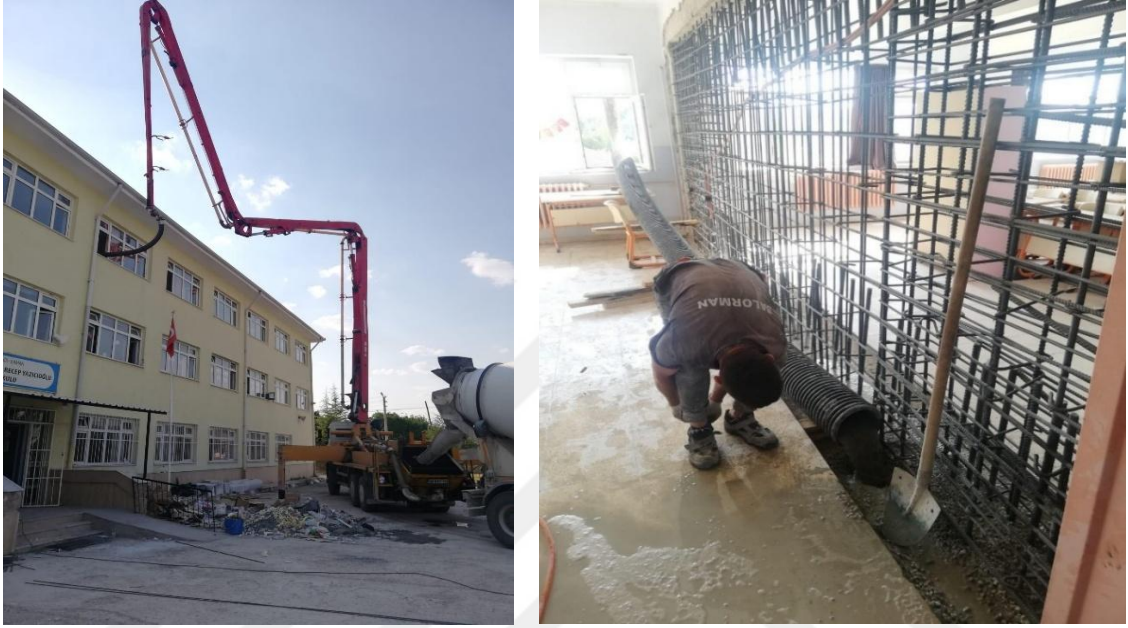
Şekil 4.116. Beton dökülme aşamaları
