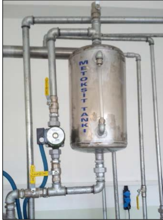
Şekil 4.21. Sirkülasyon pompası ve metoksit tankı
