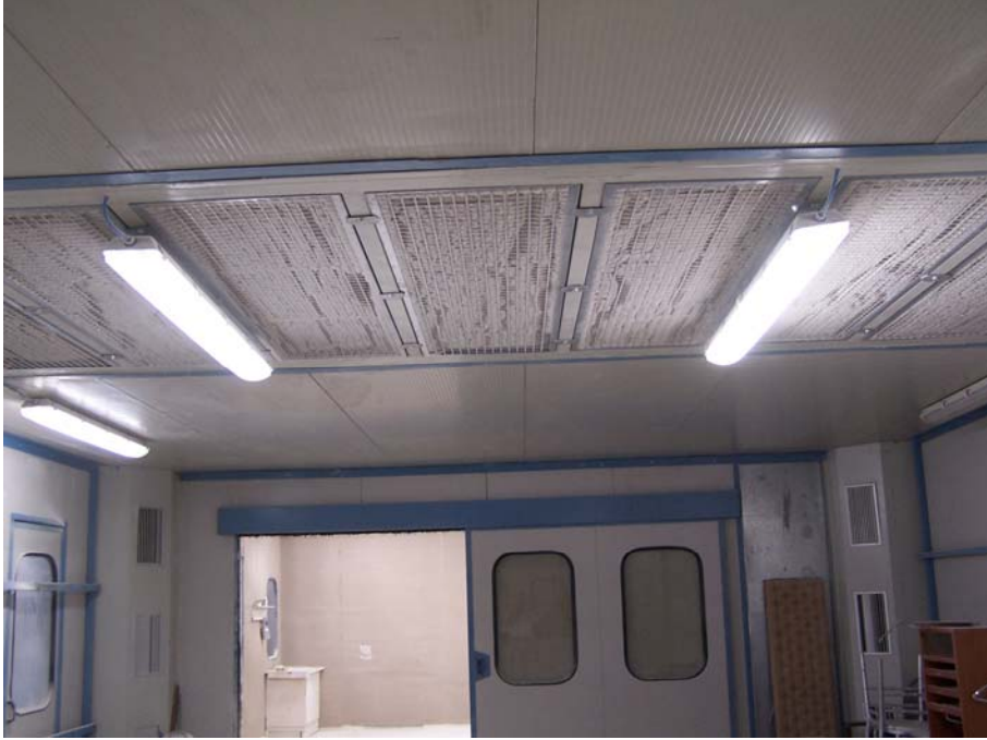
Resim 12. Püskürtme kabininde aydınlatma
