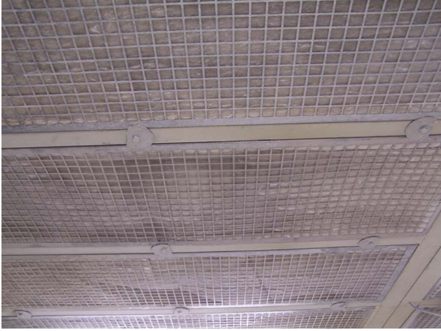
Resim 15. Püskürtme kabini tavanında fan uygulaması
