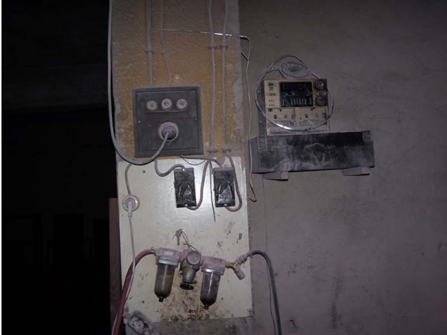
Resim 6. Elektrik sistemlerinin teçhiz edilmesinde hatalı bir örnek
