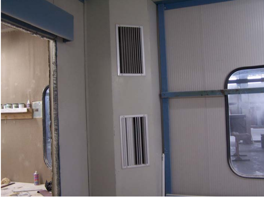
Resim 13. Püskürtme kabinde havalandırma ve ısıtma fanları
