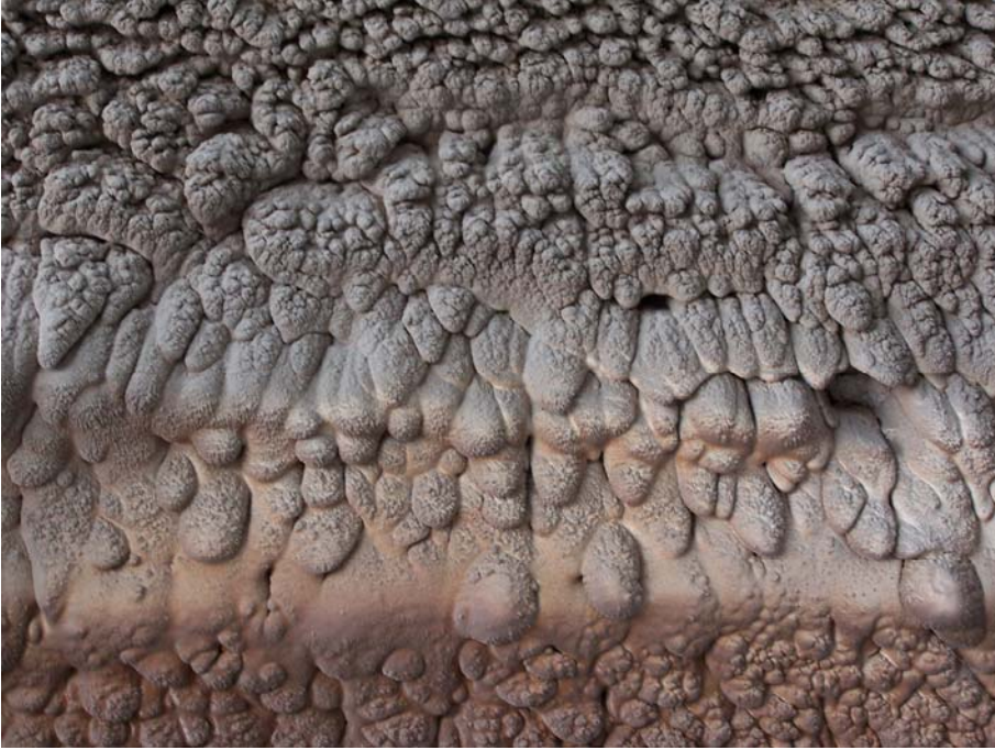
Resim 2. Duvar yüzeylerinde oluşan fiziksel bozulma
