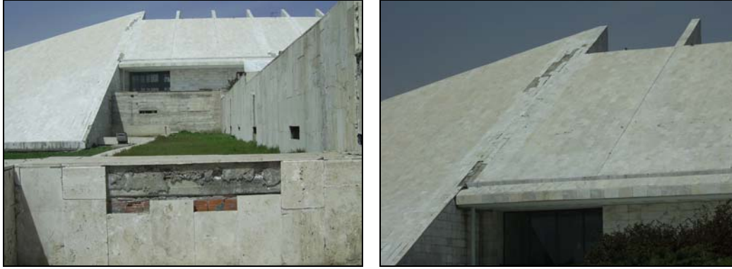
Resim 3.33. Dış cephede kullanılan mermerin bugünkü durumu [36]
