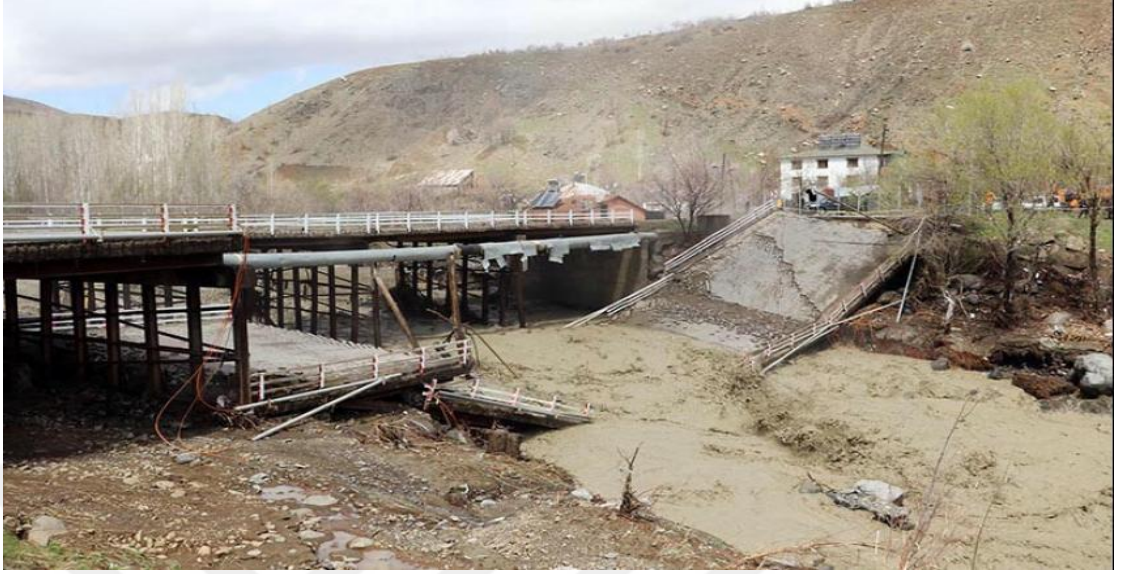
řekil 4.71 Bingöl İlinin Merkezindeki Kōprūnūn Yıkılmıř Görūntūřū (Bingöl Olay), 2019
