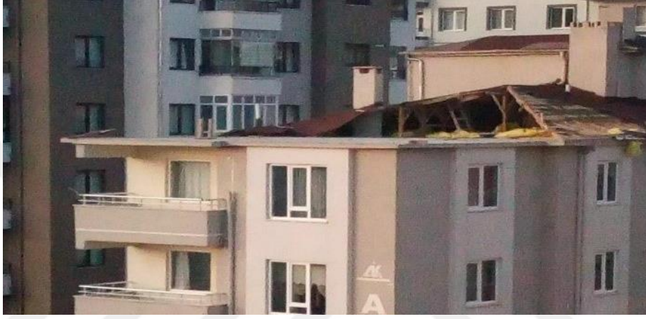
Şekil 5.2. Kayseri ili Talas ilçesi Yenidoğan Mahallesi fırtına sonrası hasar gören konut (Talas Belediyesi, 2020).
