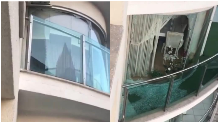
Şekil 5.7. Kayseri ili Melikgazi ilçesi Köşk Mahallesi nde fırtına sonrası hasar gören konut (URL-46).
