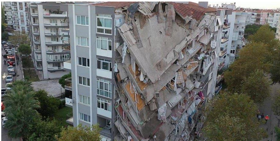
Şekil 3.16. İzmir depreminde hasar gören bina (URL-25).
