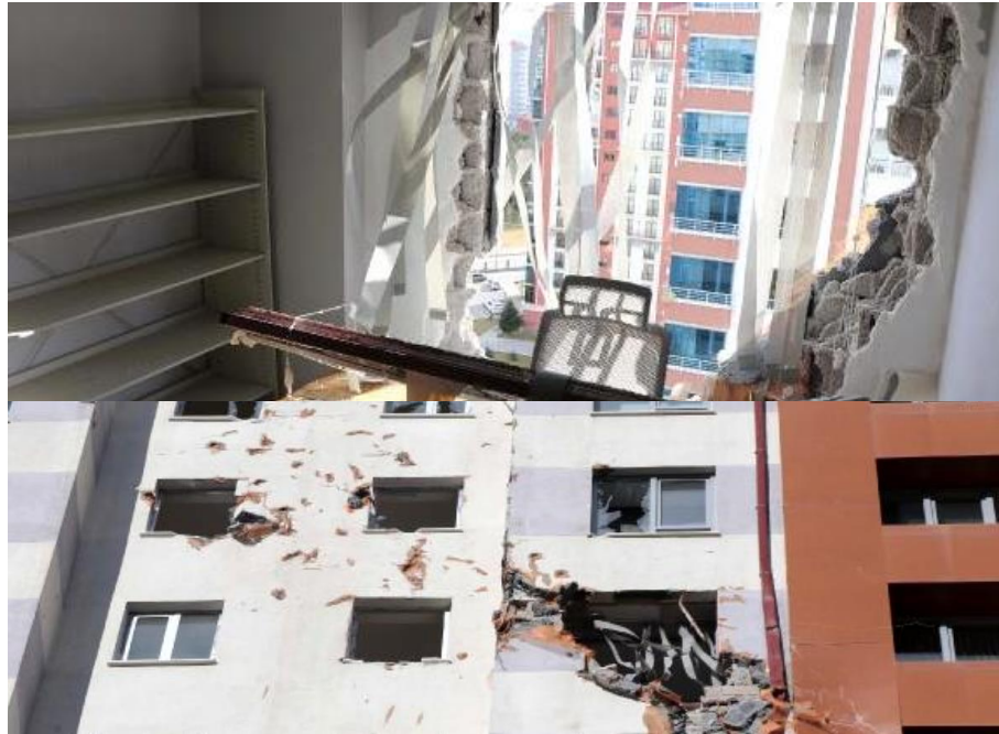
Şekil 5.5. Kayseri ili Kocasinan ilçesi Barbaros Mahallesinde fırtına sonrası hasar gören cephe (URL-34).
