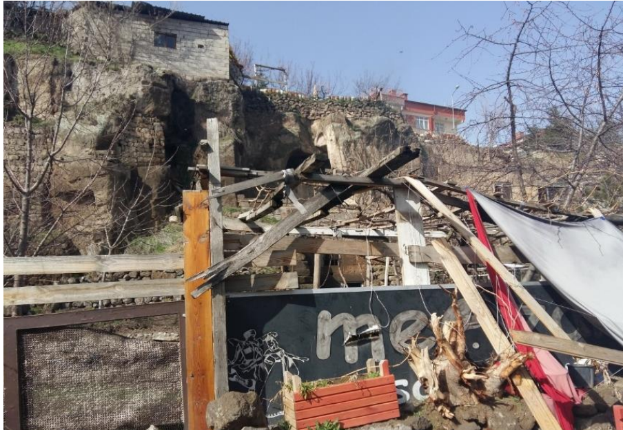
řekil 3.7. Kayseri İli Talas İlesi Kiiky Mahallesi kaya dřmesi sonucu hasar gren ticari yapılar (Kayseri AFAD 07.03.2018).
