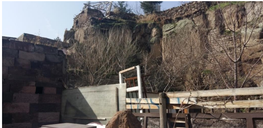
Şekil 5.9. Kayseri ili Talas ilçesi Kçüköy Mahallesi kaya düşmesi sonucu hasar gören yapılar (Kayseri AFAD, 07.03.2018).
