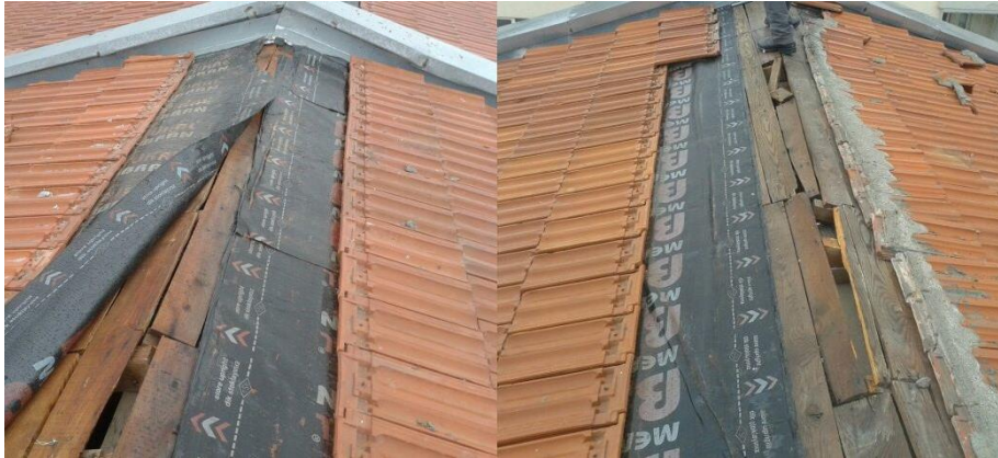
Şekil 5.3. Kayseri ili Hacılar ilçesi Yeni Mahallede fırtına sonrası hasar gören konut (Kayseri Çevre, Şehircilik Ve İklim Değişikliği İl Müdürlüğü, 2020).
