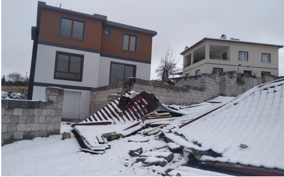
Şekil 5.1. Kayseri ili Melikgazi ilçesi Becen Mahallesi fırtına sonrası hasar gören çatı (Kayseri Çevre, Şehircilik ve İklim Değişikliği İl Müdürlüğü, 2020).
