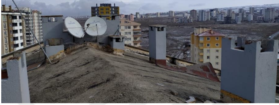
Şekil 5.6. Kayseri ili Melikgazi ilçesi Gök kent Mahallesi nde fırtına sonrası hasar gören konut (Kayseri Çevre, Şehircilik Ve İklim Değişikliği İl Müdürlüğü, 2020).
