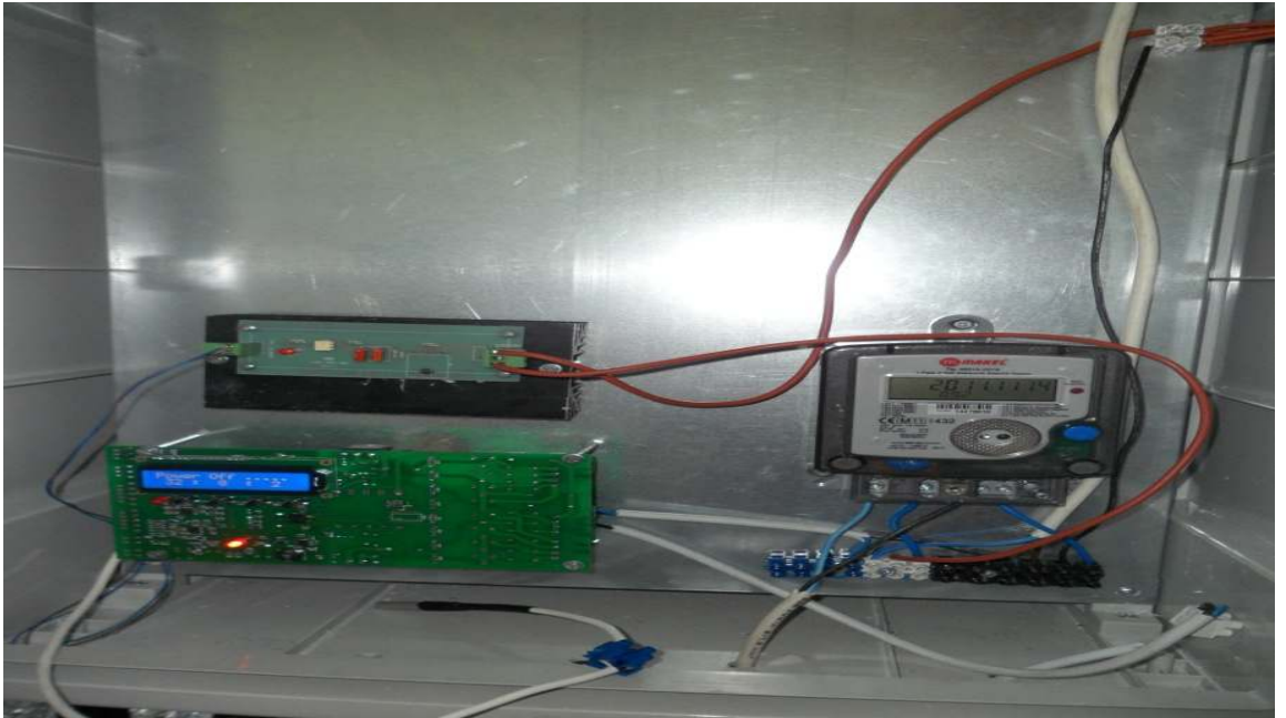
Resim 3.14. Kurutma fırını elektrik panosu
