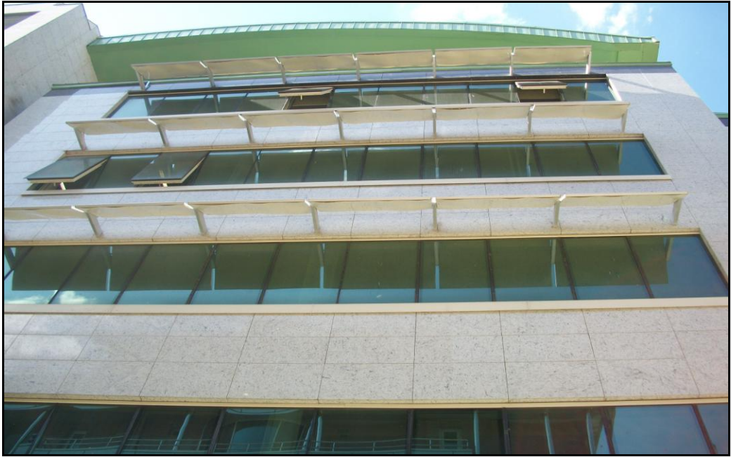
Cephedeki fotovoltaiik paneller [50]
