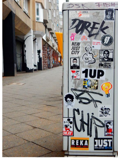
Görsel. 30 Elektrik trafosuna uygulanan stickerlar, Berlin, erişim tarihi: 9 Kasım 2023
