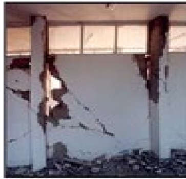
Şekil 1. 8 Kiriş ile duvar arasındaki boşluk, depremde yüksek kesme kuvvetine ve hasara neden olması
