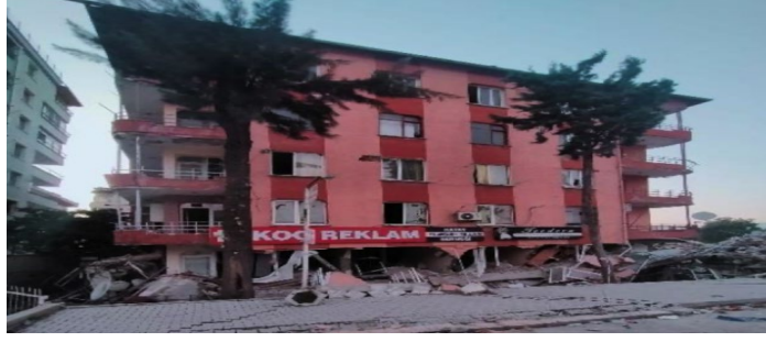
Şekil 1. 6 Dolgu duvarların dikkate alınmaması, yumuşak kat oluşumuna ve göçmeye yol açması
