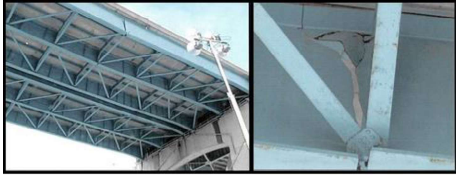
Şekil 1.6 Hoan Köprüsü tabliyesi birleşim noktalarında oluşan yorulma hasarı (Cooper, 2001)
