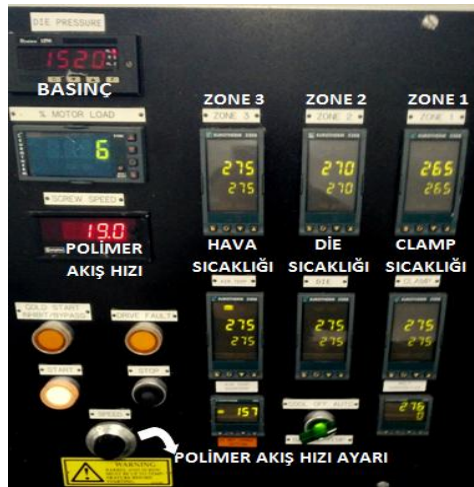
Şekil 3.2. Melt blown cihazındaki kontrol paneli
