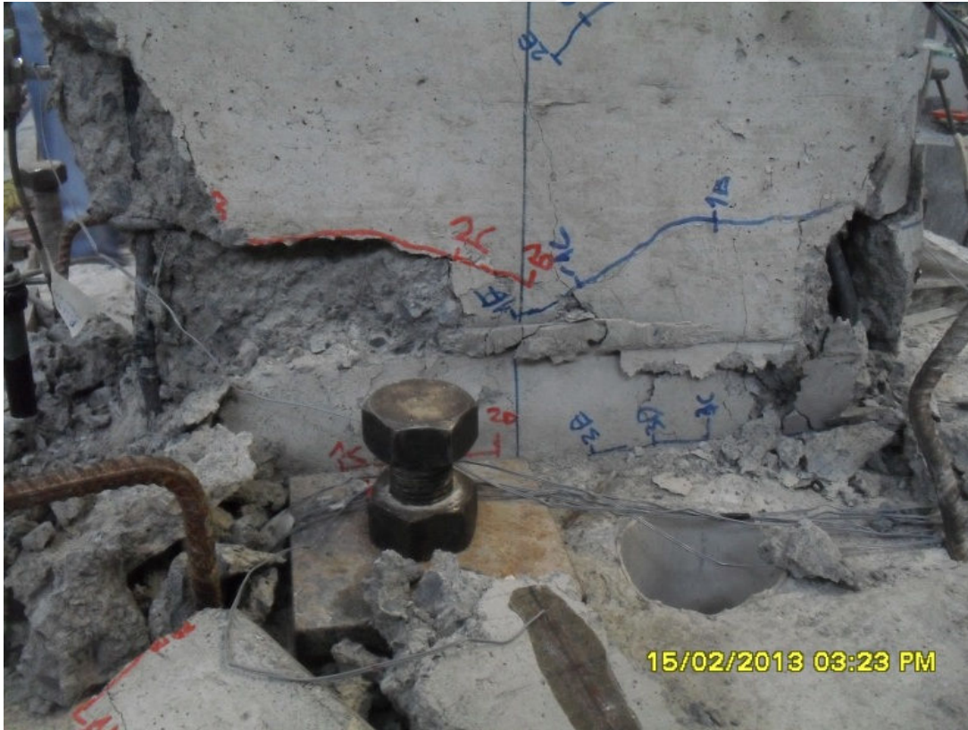
Şekil 4.13 : Yatay yük sıfırken hasar durumu.
