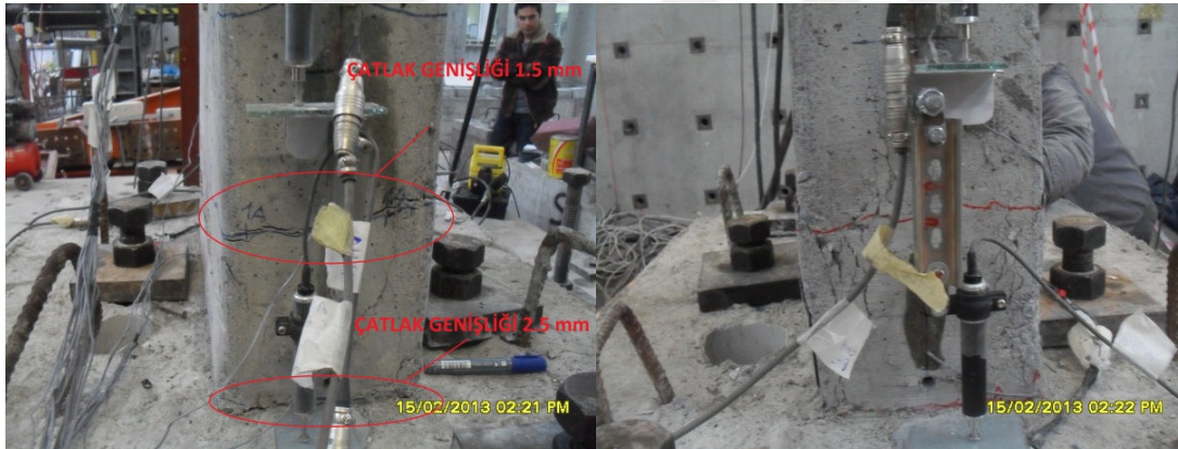
Şekil 4.6 : +0.02 görelî ötelemede çatlak genişlikleri ve hasar durumu.
