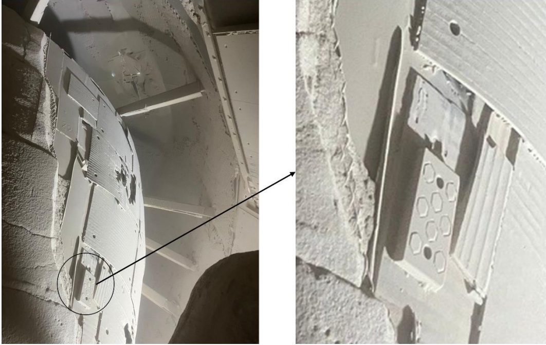
Şekil 40. Batisöke Çimento Sanayi işletmesinde bulunan farin değirmeni içerisinde yerleştirilen Hardox 450 + alümina hibrit aşınma plakasının 5 ay sonraki görüntüsü
