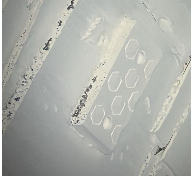
Şekil 39. Batisöke Çimento Sanayi işletmesinde bulunan farin değirmeni içerisine yerleştirilen yüksek manganlı çelik + alümina hibrit aşınma plakasının 3 ay sonraki görüntüsü
