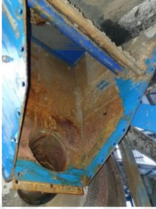
Şekil 2. Etibakır Giresun Lahanos işletmesinde bulunan ve kalıcı deformasyona uğramış değirmen besleme şutu
