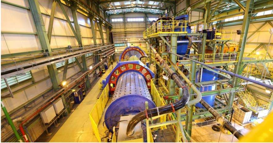
Şekil 3.4. Cevher hazırlama tesisinde kullanılan değirmenler ( www.tuprag.com.tr ).
