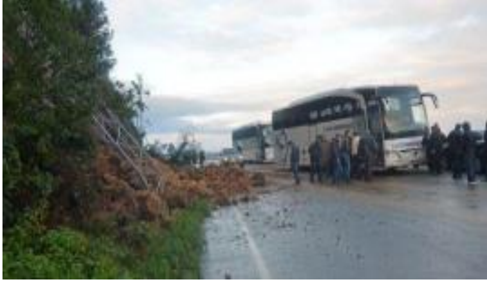
Şekil 3. Doğada düşme yenilmeleri Arhavi-Hopa Devlet Yolu (KGM, 2015)
