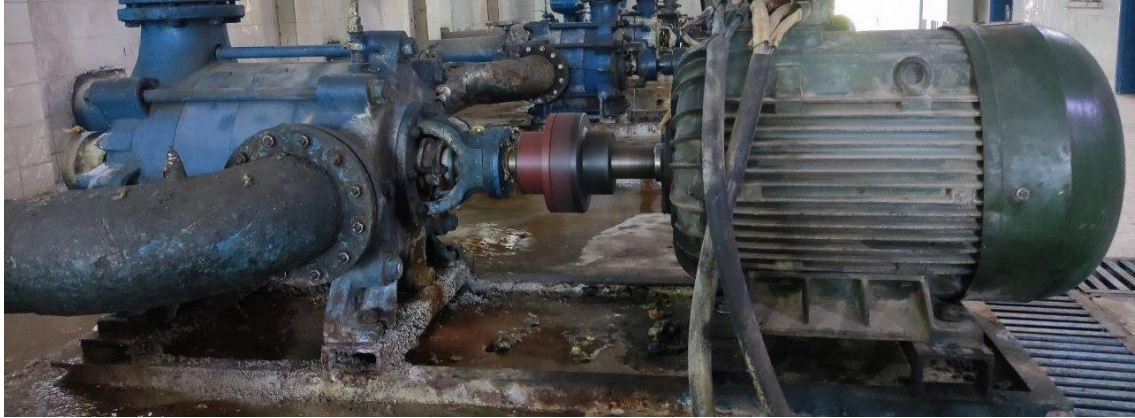
Şekil 3.4. Bismil Terfi Merkezi 3 nolu(A3) Pompa
