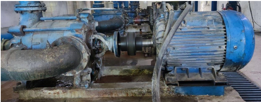
Şekil 3.3. Bismil Terfi Merkezi 2 nolu(A2) Pompa
