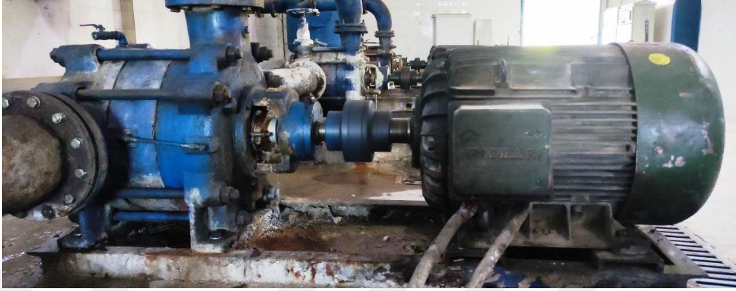
Şekil 3.5. Bismil Terfi Merkezi 4 nolu(B1) Pompa
