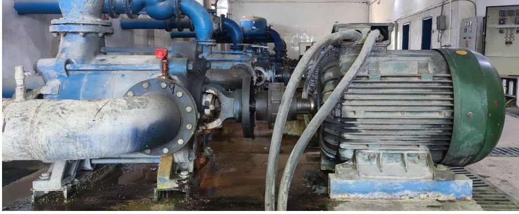
Şekil 3.2. Bismil Terfi Merkezi 1 nolu(A1) Pompa
