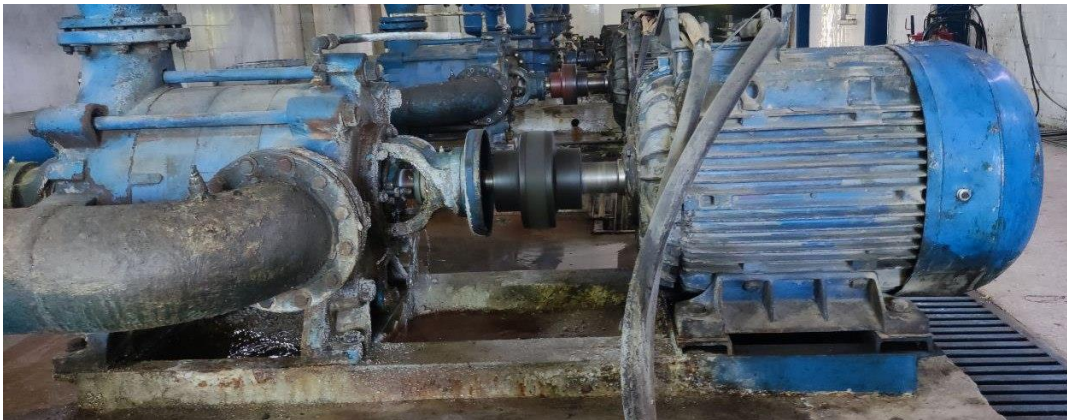
Şekil 3.3. Bismil Terfi Merkezi 2 nolu(A2) Pompa
