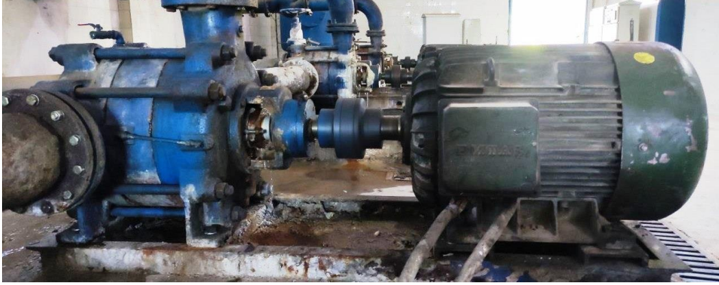
Şekil 3.5. Bismil Terfi Merkezi 4 nolu(B1) Pompa
