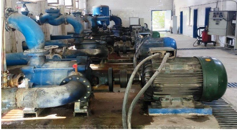
Şekil 1.4. Çok kademeli grup pompa (Bismil Terfi Merkezi 1 nolu pompa, 3 kademeli)
