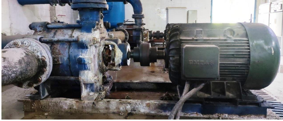
Şekil 3.6. Bismil Terfi Merkezi 5 nolu(B2) Pompa
