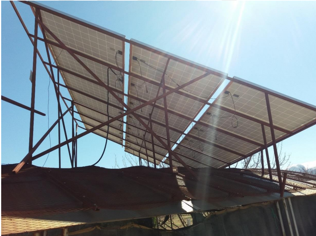
Şekil 5.4 Tesisteki panellerin karkas yapısı ve kablolar
