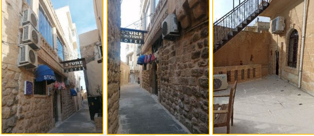
Şekil 4.17 Solda ve ortada, Stone Otel güney cephesi klima dış üniteleri; sağda 2. Kat terası güney cephesi klima motorları
