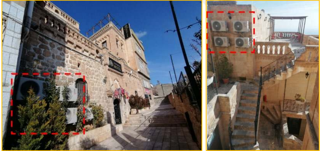
Şekil 4.20 Zinciriye Otel solda güney cephesinde klima üniteleri, sağda terasa bakan cephede klima üniteleri
