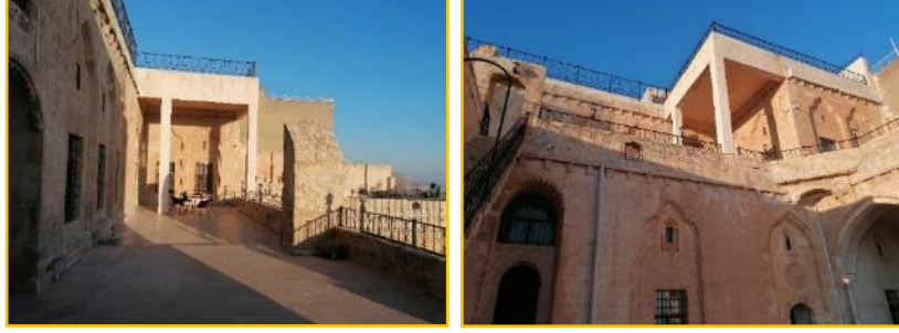
Şekil 4.33 Kasrı Abbas Pansiyon 2. Kat terasındaki betonarme eklenti
