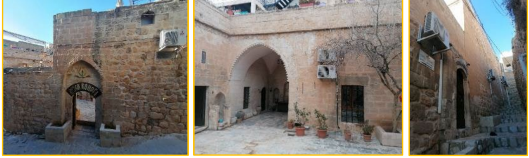
Şekil 4.19 Soldan sağa; Dara Konağı giriş cephesinde, avluya bakan cephede, doğu cephesinde klima dış ünitesi kullanımı
