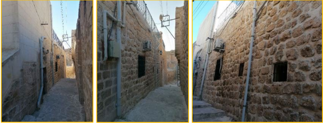
Şekil 4.18 Kasrı Abbas Pansiyon kuzey cephesi tesisat boruları ve klima dış ünitesi kullanımı
