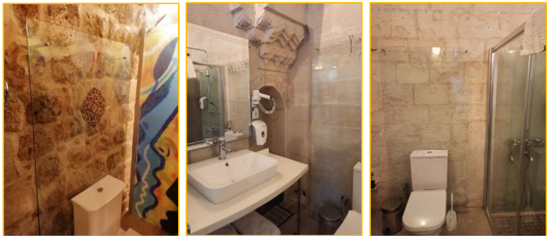
Şekil 4.54 Islak hacimde evye-lavabo gibi elemanlarla taş duvar arasında cam uygulaması; solda Tarihî Selçuklu Konağı, ortada ve sağda Mardin Osmanlı Konağı
