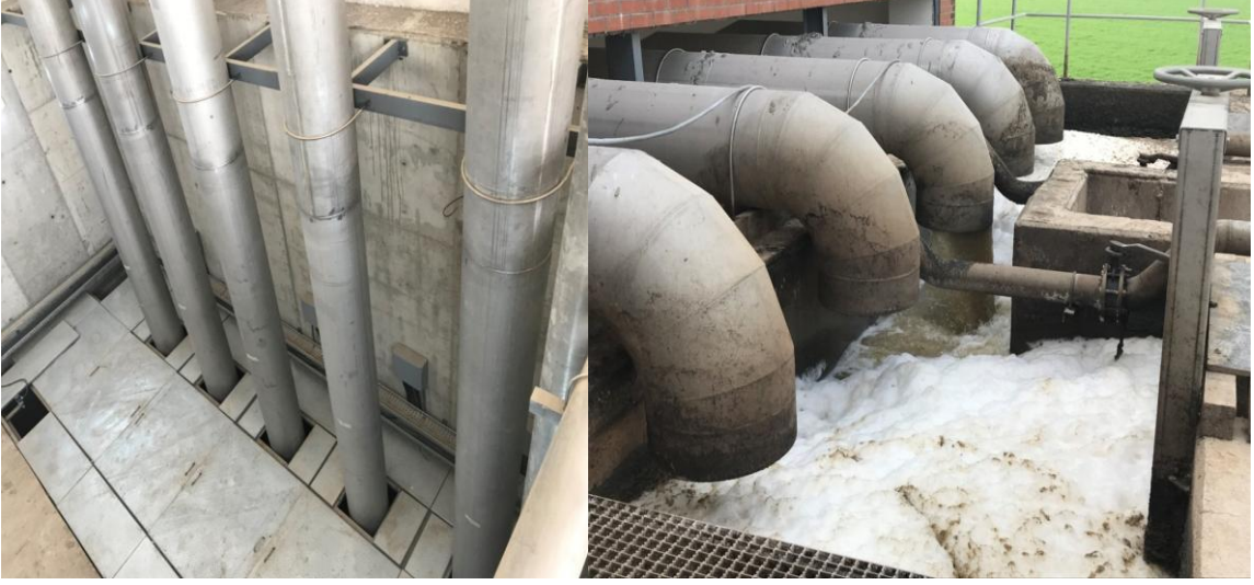
Resim 2.4. Giriş pompa istasyonu
