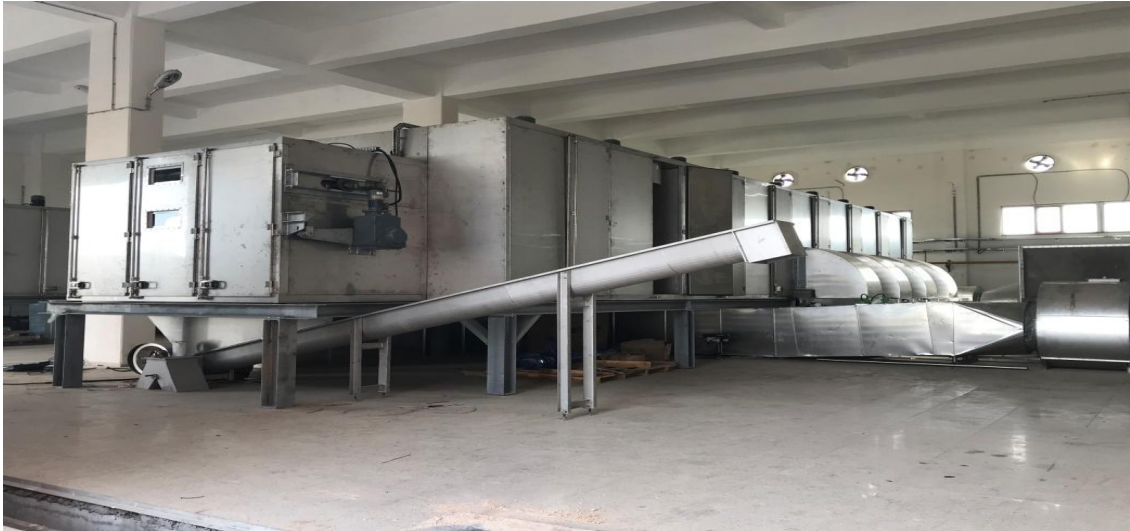
Resim 2.17. Çamur kurutma ünitesi
