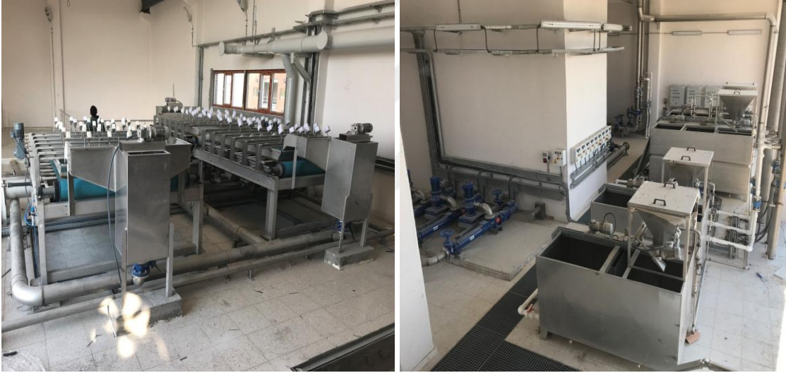
Resim 2.12. Mekanik çamur yoğunlaştırma
