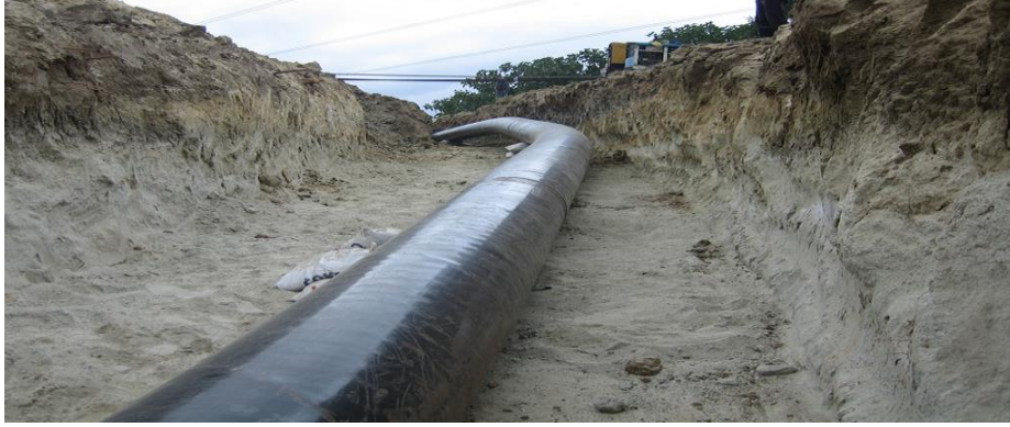
Şekil 2.2 Doğalgaz boru hattının görünüşü (BOTAŞ, 2018)
