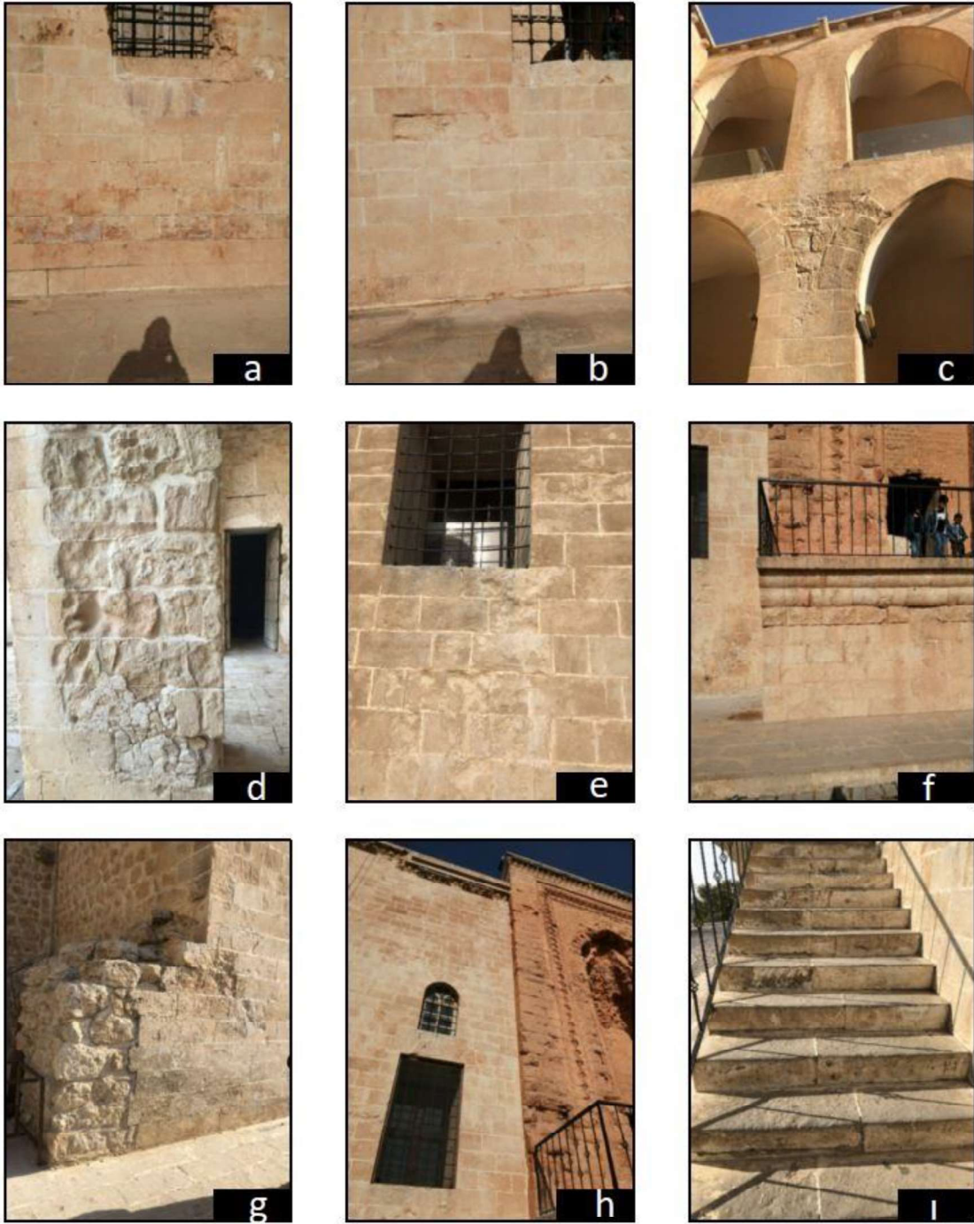
Şekil 4.1. Kasımiye Medresesinde meydana gelen fiziksel bozunmalar (Kasım 2019)
