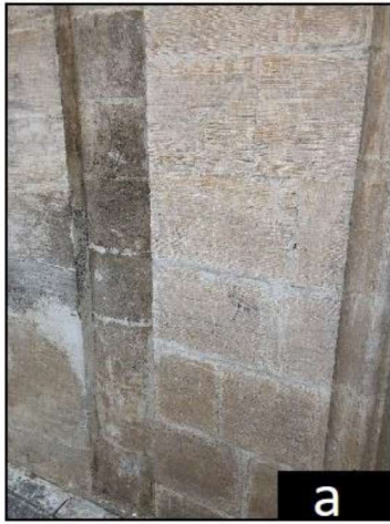
Şekil 4.16. Şehidiye Medresesinde insan etkisi sonucunda meydana gelen bozunmalar (Kasım 2019)
