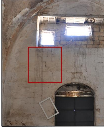
Şekil 4.51. Batı Duvarı Çatlak
