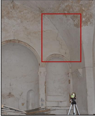
Şekil 4.50. Apsis Duvarındaki Çatlak
