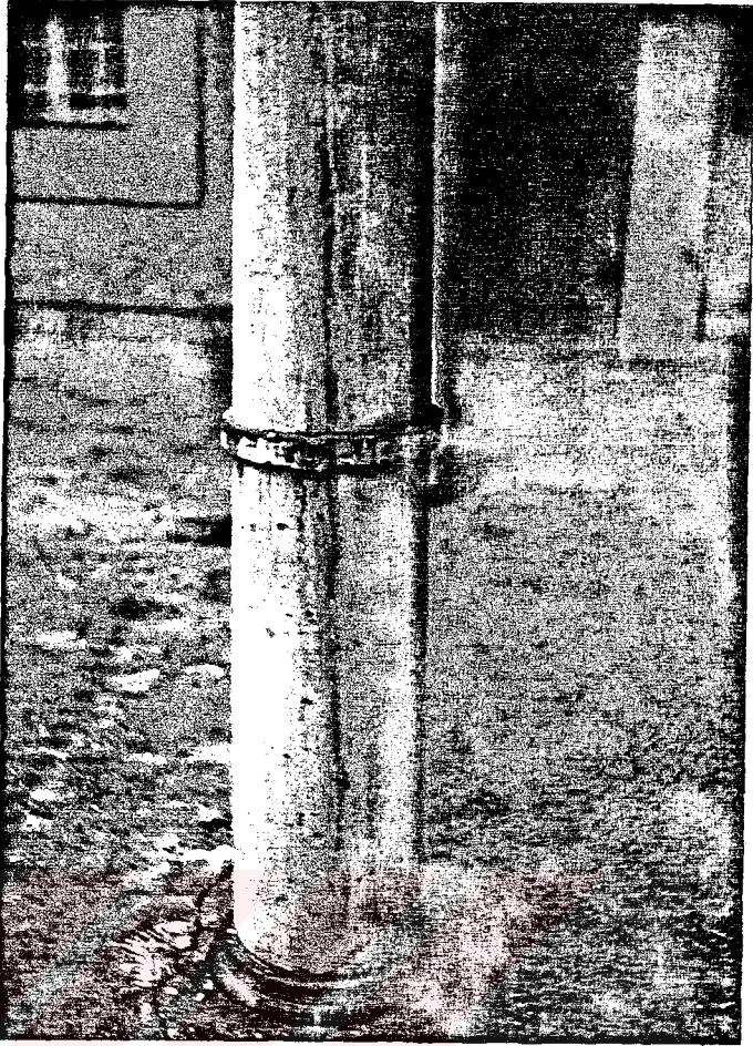
Foto: 75. Sütunlardaki Boyuna Çatlaklar.
