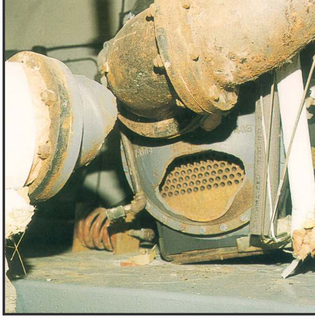
Şekil 2.8. Soğutma grubunun boru bağlantısında meydana gelen hasar
