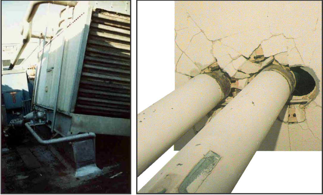
Şekil 2.4. Deprem koruması yapılmamış tesisat donanımlarında hasar oluşumu
