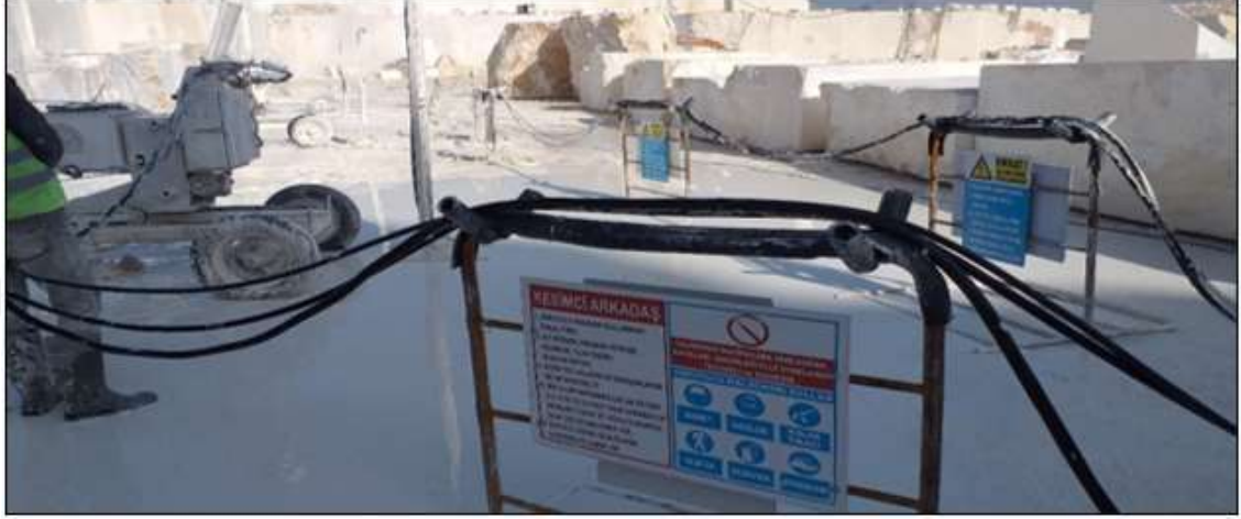
Şekil 28. Yazlık alanında kablo askılığı ve elektrik kabloları
