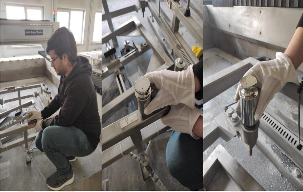
Resim 3.14 Yk hcrelerinin lm doęruluklarının kontrollerine ait grseller.
