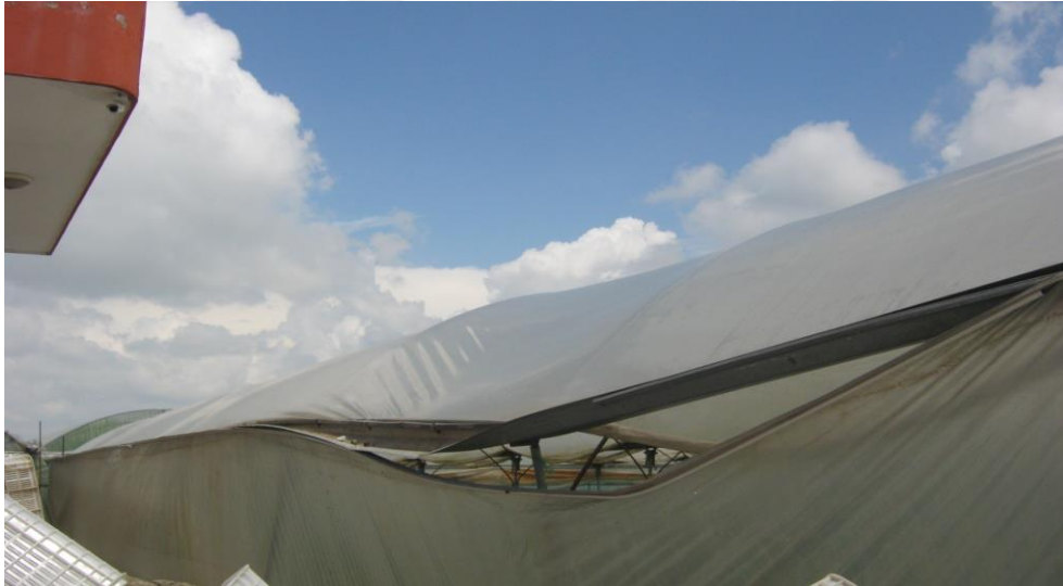
Fotoğraf 4.5. Adanalıoğlu Uygun Olmayan Şekilde Kurulan Serada Meydana Gelen Hasar
