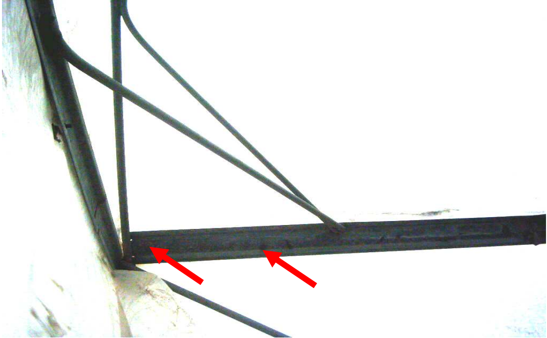
Resim 4.9. Uygun Olmayan Malzeme ve Yapım Tekniğinin Kullanılması Sonucu Konstrüksiyonda Oluşan Korozyon (Adanalıoğlu, 2003)
