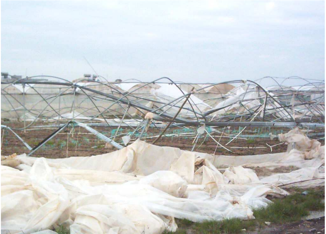
Resim 4.7. Uygun Olmayan Malzeme ve Yapım Tekniğinin Kullanılması Sonucu Yıkılan Yay Çatılı Sera (Adanalıoğlu, 2003)
