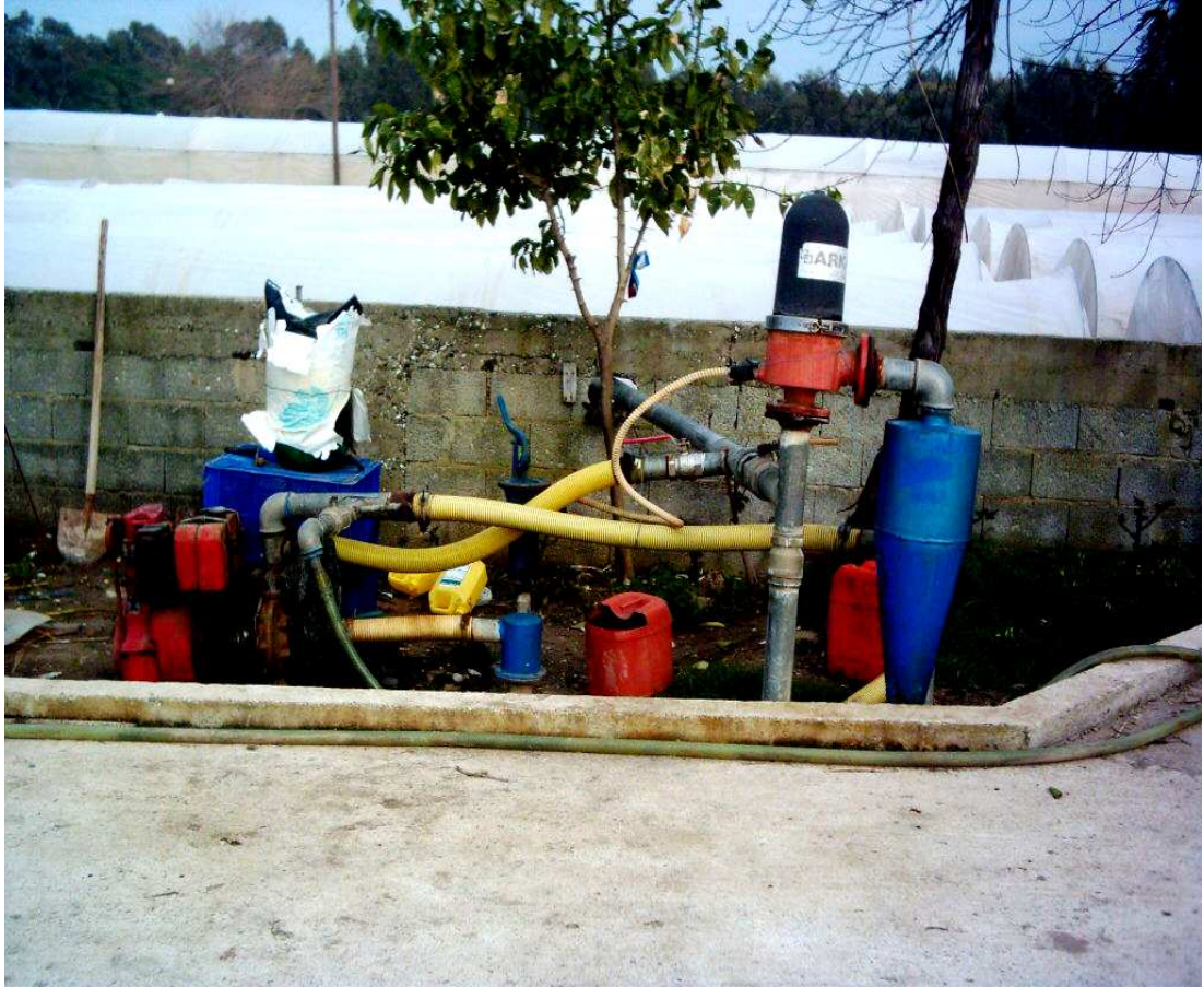
Resim 4.15. Damla Sulama Sistemi Kontrol Ünitesinin Görünüşü (Erdemli, 2003)
