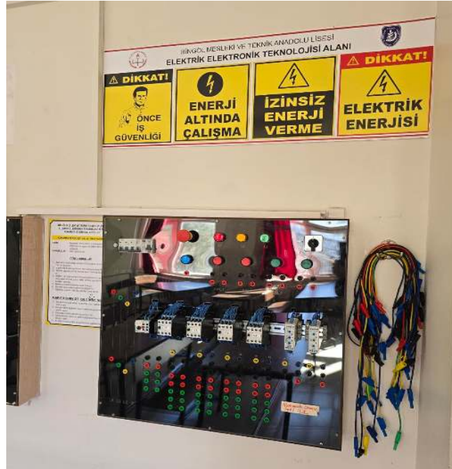
Şekil 3.2. Elektrik atölyesi kumanda deney seti
