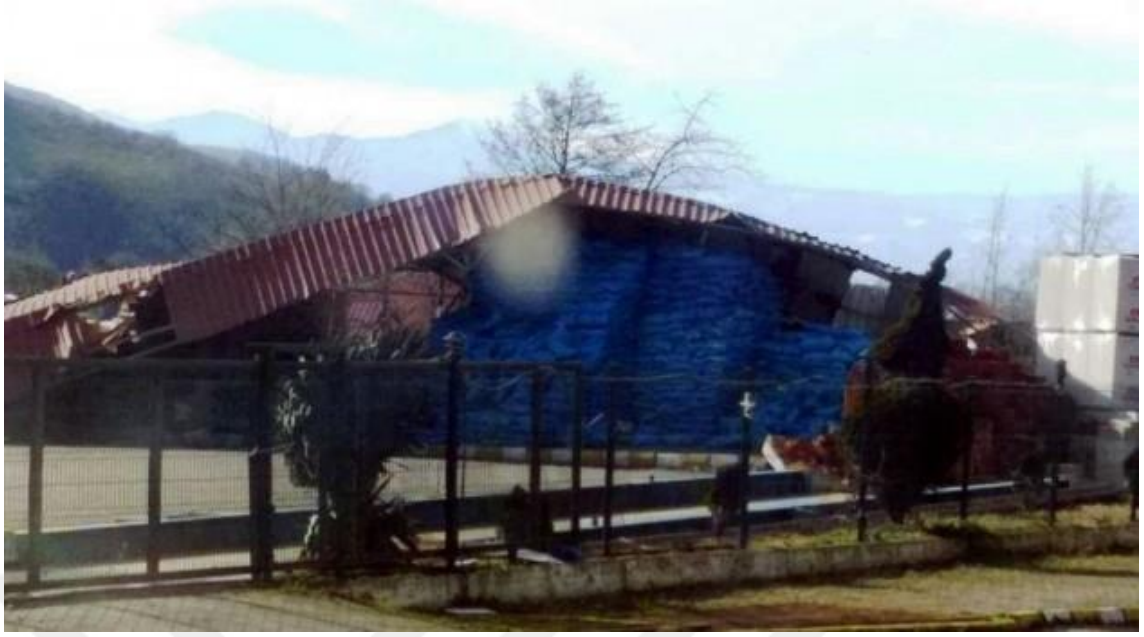
Şekil 1.4. Sakarya’da iş yeri deposu çatısı uçması(URL-4).
