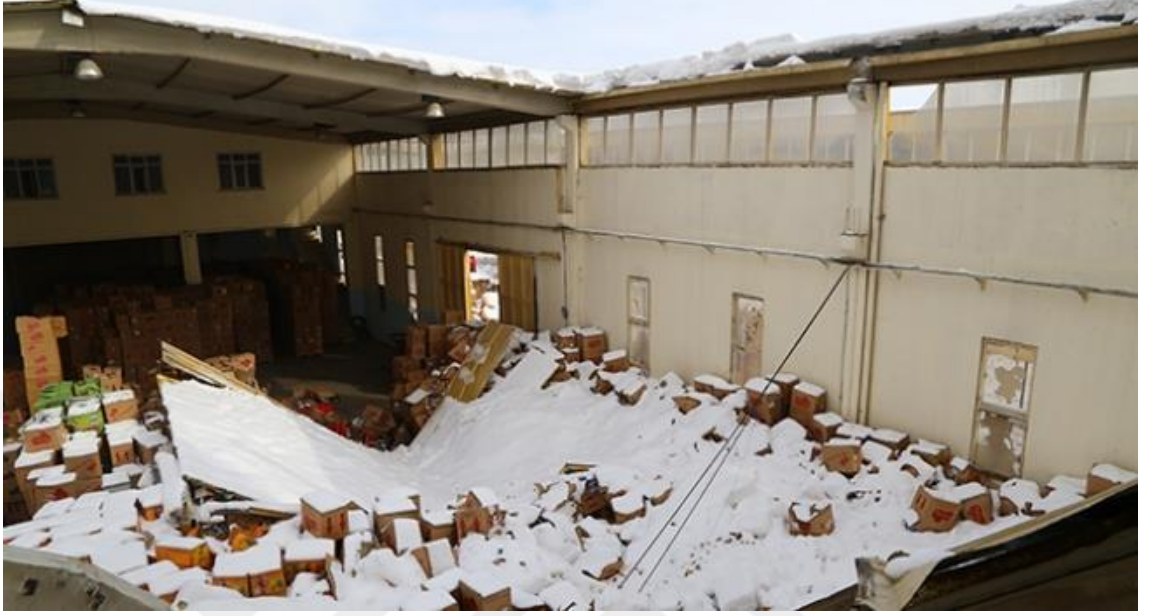
Şekil 1.2. Konya’da fabrika çatısı çökmesi(URL-2).
