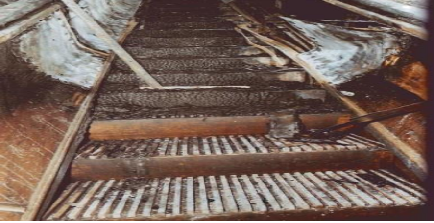
Şekil 4.27: Londra metrosu yangın sonrası yürüyen merdivenlerin görüntüsü
