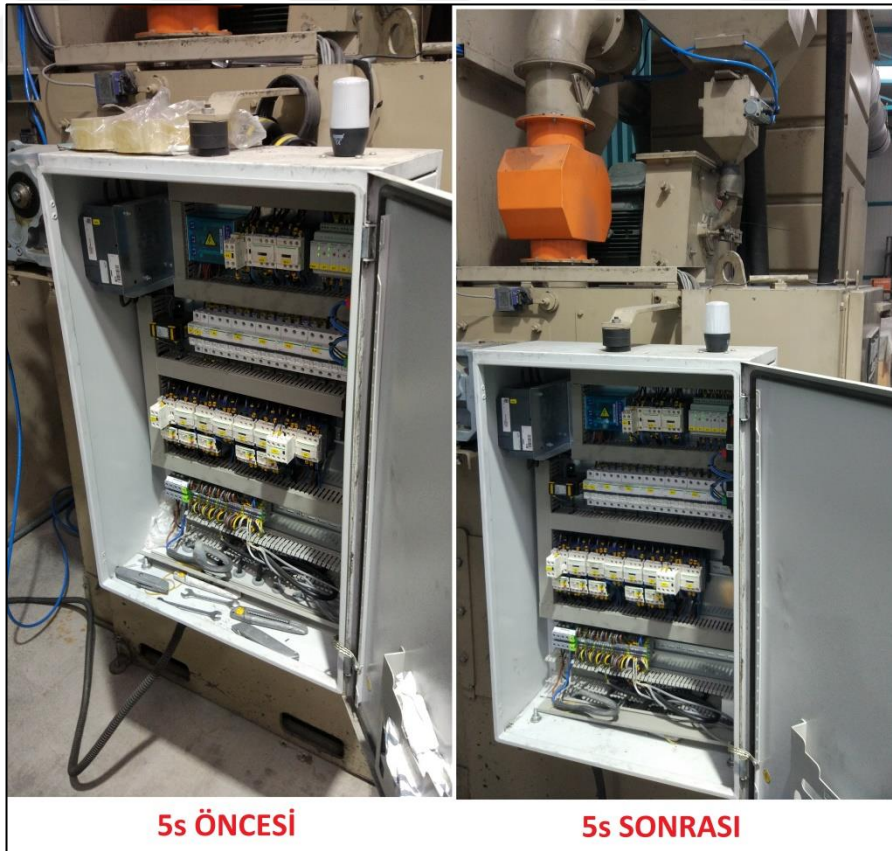
Şekil 27: 5S Temizleme Fazı Fotoğrafları – Elektrik Panosu
