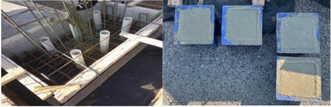
Şekil 13. Temel betonu dökülmesi ve numune alınması
