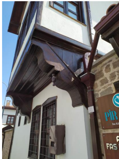
Şekil 4.71 Mahmut Dede Sk. No:21’de yer alan yapının mevcut durumu, cumbayı taşıyan ahşap elemanlar
