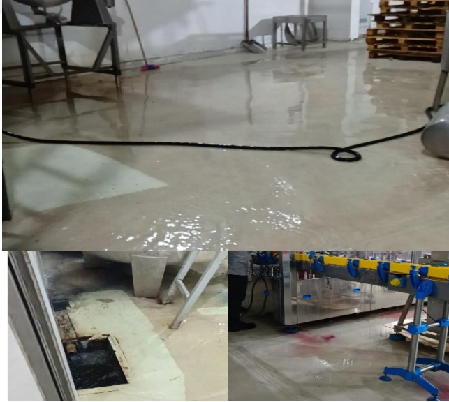
Şekil 19. Yetersiz drenaj alt yapısından kaynaklı oluşan zemim görüntüleri
