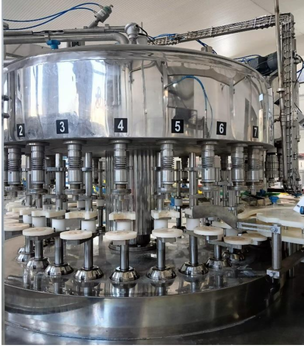
Şekil 26. Gürültülü çalışan dolum ünitesi
