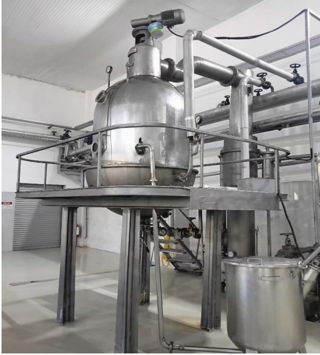
Şekil 23. Yüksek ısı ile çalışan buhar kazanı
