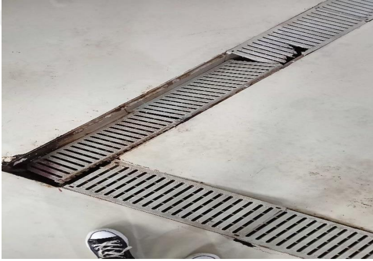
Şekil 17. Deforme olmuş zemin görseli
