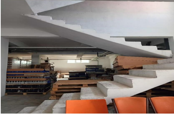
Şekil 16. Korkuluk bulunmayan merdiven görseli
