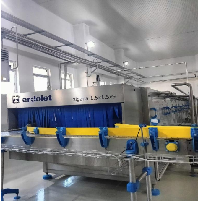
Şekil 25. Gürültülü çalışan soğutma ünitesi
