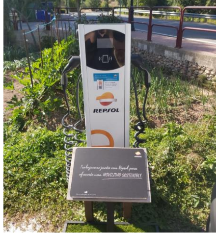
Fotoğraf 6.8. Park alanında bulunan elektrikli araç şarj istasyonu
