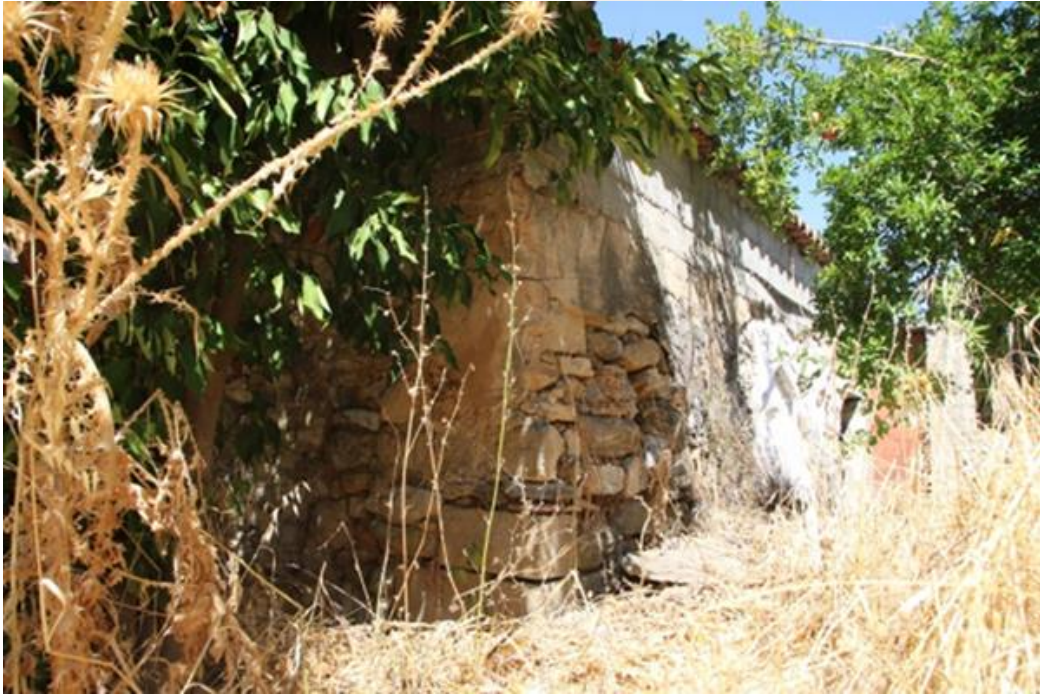
Şekil 4.78. Çeşmenin toprak altında kalan duvarı
